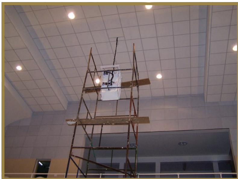
A laje recebeu jateamento de fibra de celulose e, logo abaixo, a instalação de um forro acústico em estrutura modular
